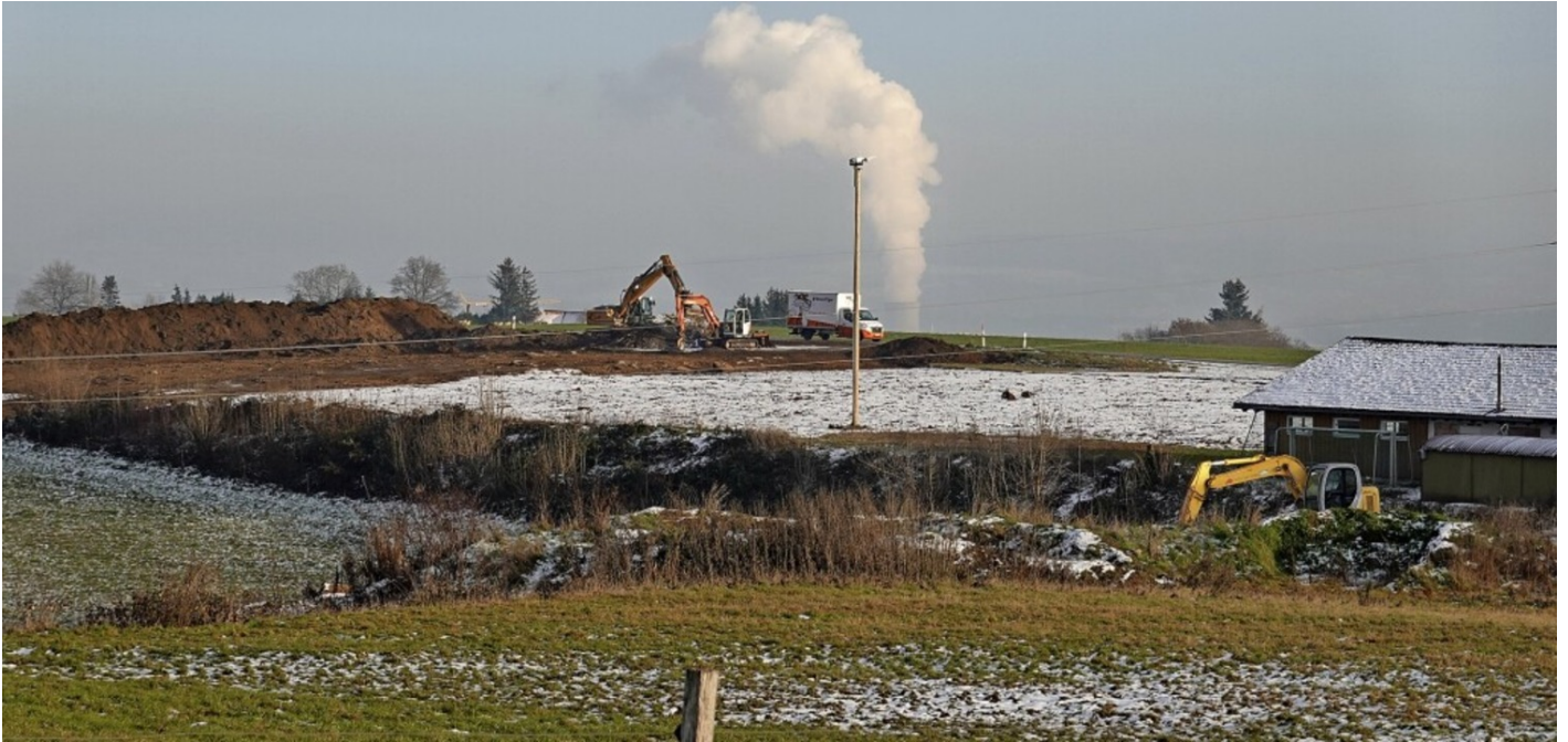
Beim Sportplatz in Oberwihl ist der Spatenstich erfolgt, und fleißig werden bereits die Humusflächen entfernt. Foto: Hans-Jürgen Sackmann
