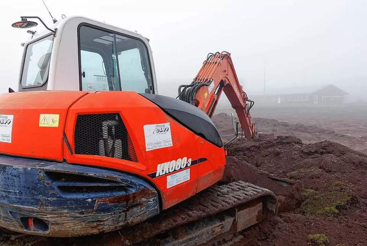
Auf dem Hardtpark in Oberwihl hat der Bagger erste Arbeiten geleistet – auch im Nebel. | Bild: Peter Schütz
